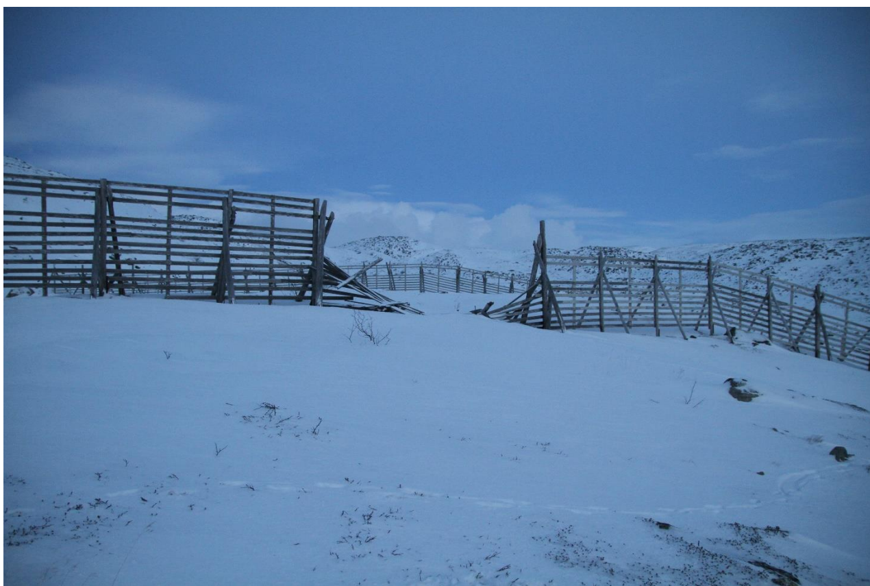
Figur 4: Eksisterende snøskjerm. Bildet er tatt under befaringen i oktober 2019. Ved flere steder er konstruksjonene ødelagt.
