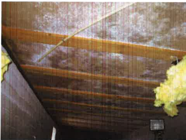
Muggsopp i overflaten på stubbplater.
